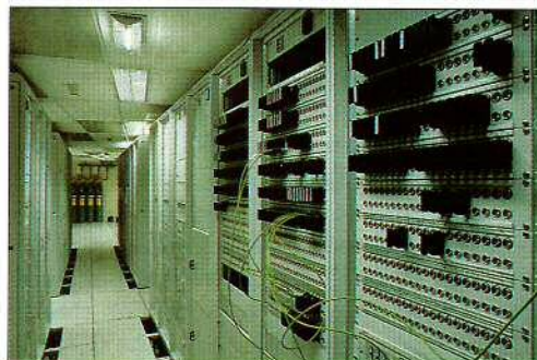
Alignements de baies du CDN.
