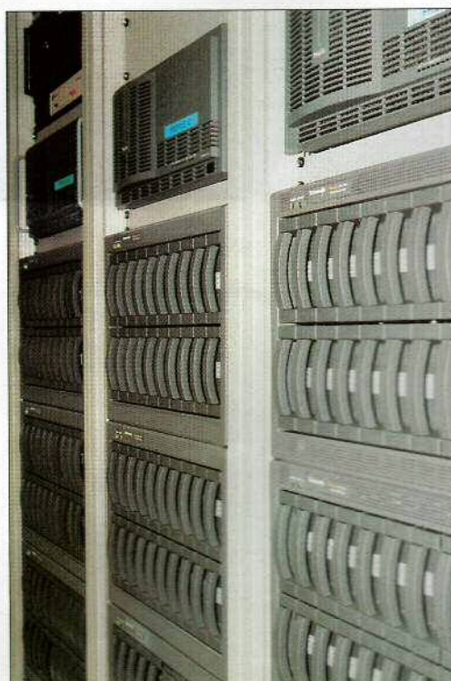
Une partie des baies de serveurs Profile.
