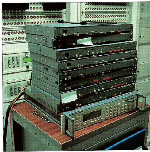
Multiplexeurs et démultiplexeurs en test avant leur mise en place.
