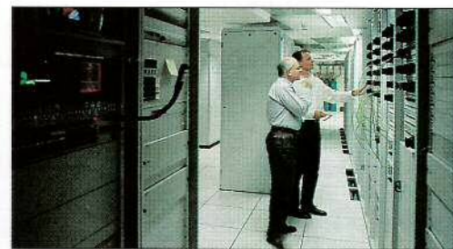
Alignements de baies du CDN.
